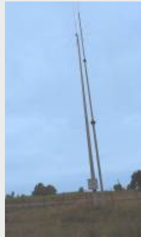
Sterownik CB KomuniCATORa oraz maszty anteny zlokalizowane przy drodze (przykład realizacji)
