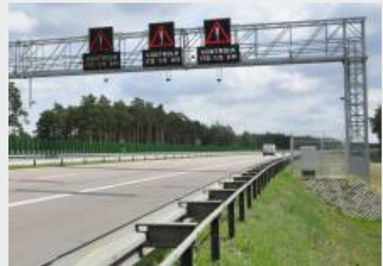
Przykładowa instalacja systemu ViverWim na autostradzie A2
